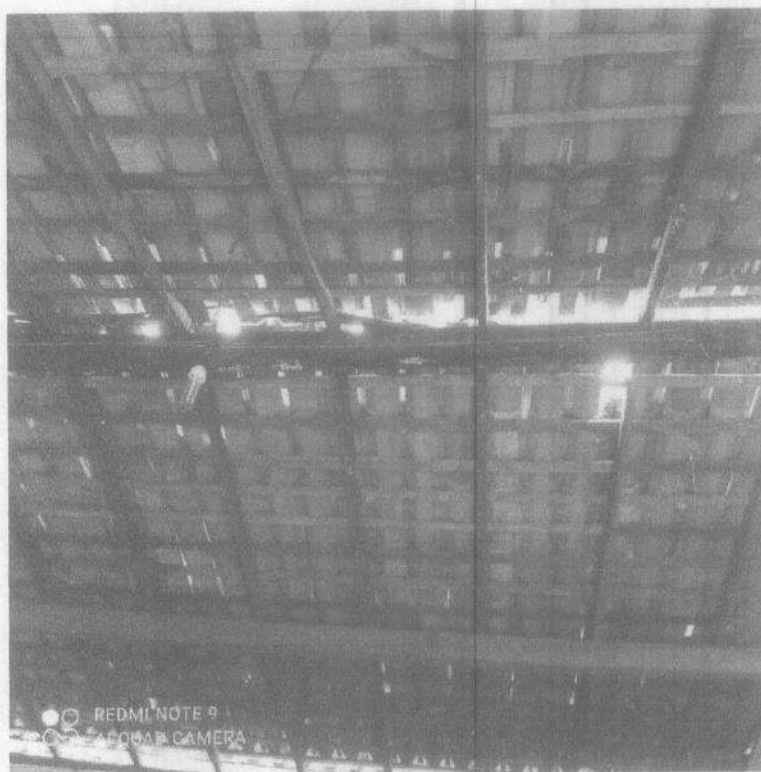
Figura 03: Telhado deteriorado sem manutenção
