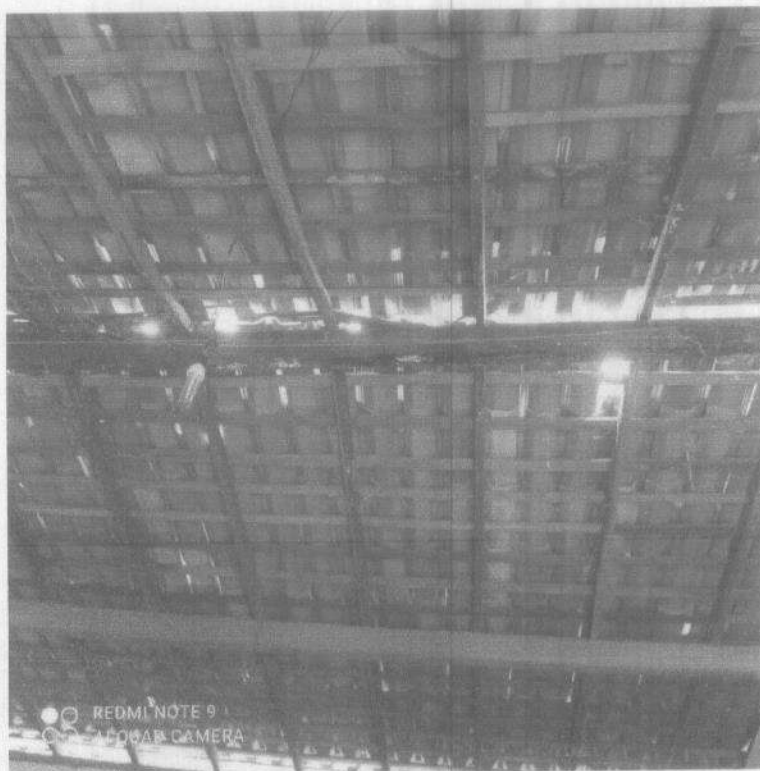
Figura 03: Telhado deteriorado sem manutenção
